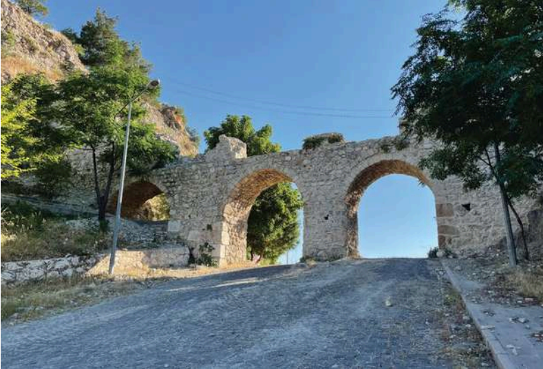
Şekil 14. Kırıkhan, Darb-ı Sak Kalesi, Depremde Hasar Gören Su Kemerini (Fotoğraf: Zeynep Ahunbay).
