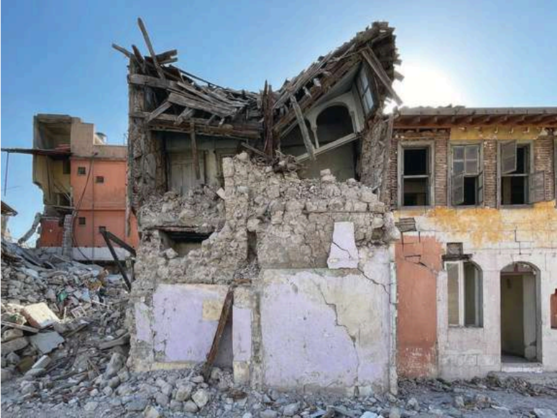
Şekil 7: Deprem Sonrası Kagir Bir Yapı (Fotoğraf: Ömer Selçuk Baz).
