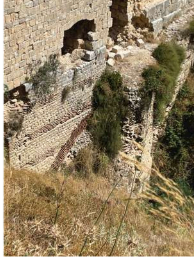
Şekil 3. Antakya, Demir Kapı, Deprem Hasarları (sağda) (Fotoğraf: Zeynep Ahunbay).
