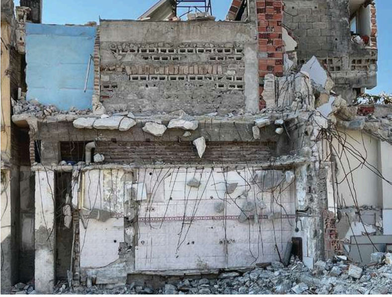
Şekil 8: Deprem Sonrası Antakya Fotoğraf: Ömer Selçuk Baz .
