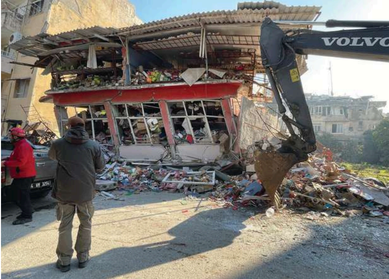
Şekil 5: Deprem Sonrası Antakya Fotoğraf: Ömer Selçuk Baz).
