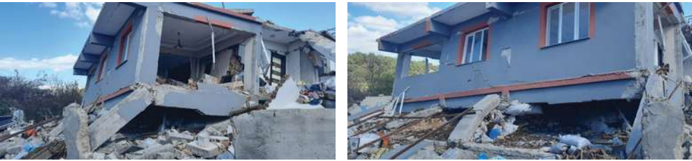
Şekil 11. Deprem Sonrası Antakya Kırsalında Hasarlı Bir Yapı, Şubat 2023 (Fotoğraflar: Ali Tolga Özden).
